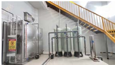
图 9 风电场净水设施
