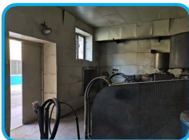
风机房采用吸音材料降低噪音
